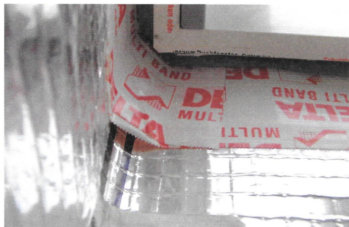
▲ Hier wurde das Klebeband unter Spannung eingebaut und beginnt sich in den Knickbereichen bereits abzulösen
