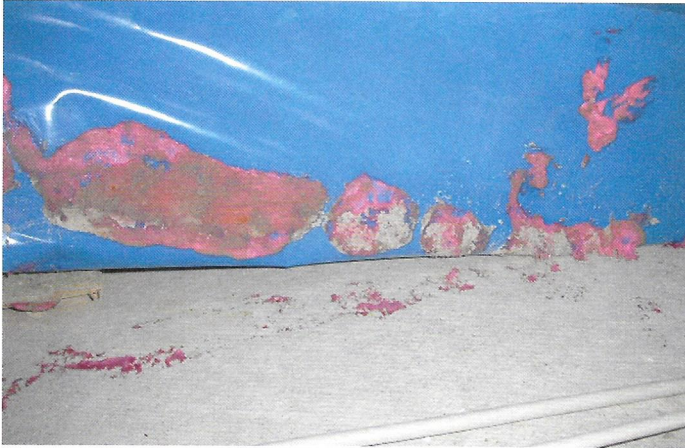
▲ Dieser staubige Untergrund wurde nicht gereinigt und vorbehandelt. Auch eine noch so große Klebemittelmenge kann hier nicht halten
