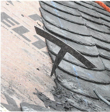
▲ Nie dicht: Durch die Arbeit mit der Haubücke wird die Vordeckbahn bereits beschädigt
