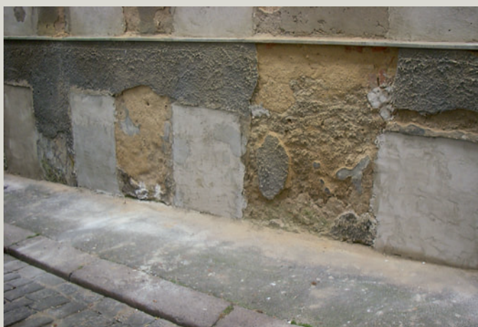
Sokl před opravou.
