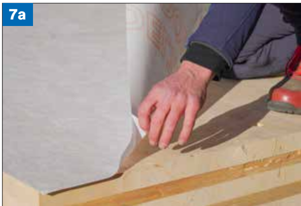
(Figures 7a et 7b) Retirer le film pelable FP 2 sur le même principe que décrit ci-dessus. Veiller à ce que le film pelable FP 2 soit légèrement tendu dans le sens de déroulement de la membrane afin d'éviter tout risque de déchirure.
