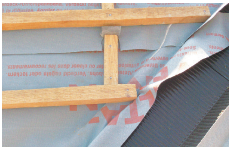
Рис. 8. Ошибка: Отсутствует гидроизоляционный материал под желобком ендовы. Обрешетка прибита слишком близко к линии стока воды.
