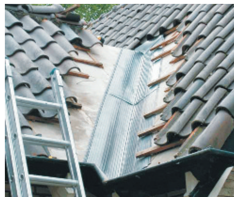
Рис 2. Ошибка: желобок уложен поверх гидроизоляции и прибит гвоздями по краям. Подкровельный материал поврежден по всей длине ендовы
