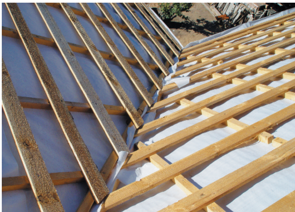
Рис 4. Ошибка: гидроизоляция уложена с разрывом, контробрешётка прибита гвоздями по линии возможного стока воды, отсутствуют вентиляционные продухи.
