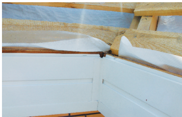
Рис. 9. Ошибка: Водоотвод с ендовы перекрыт обрешёткой и подшивкой карниза
