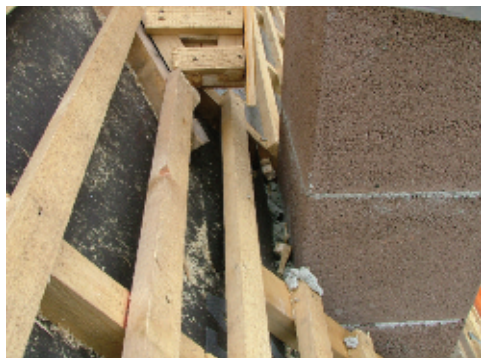
Рис. 5 Ошибка: не выполнен дренажный желобок, подкровельная пленка не приклеена к трубе
