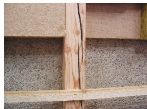
Рис. 2. Трещины и расслоения стропил
