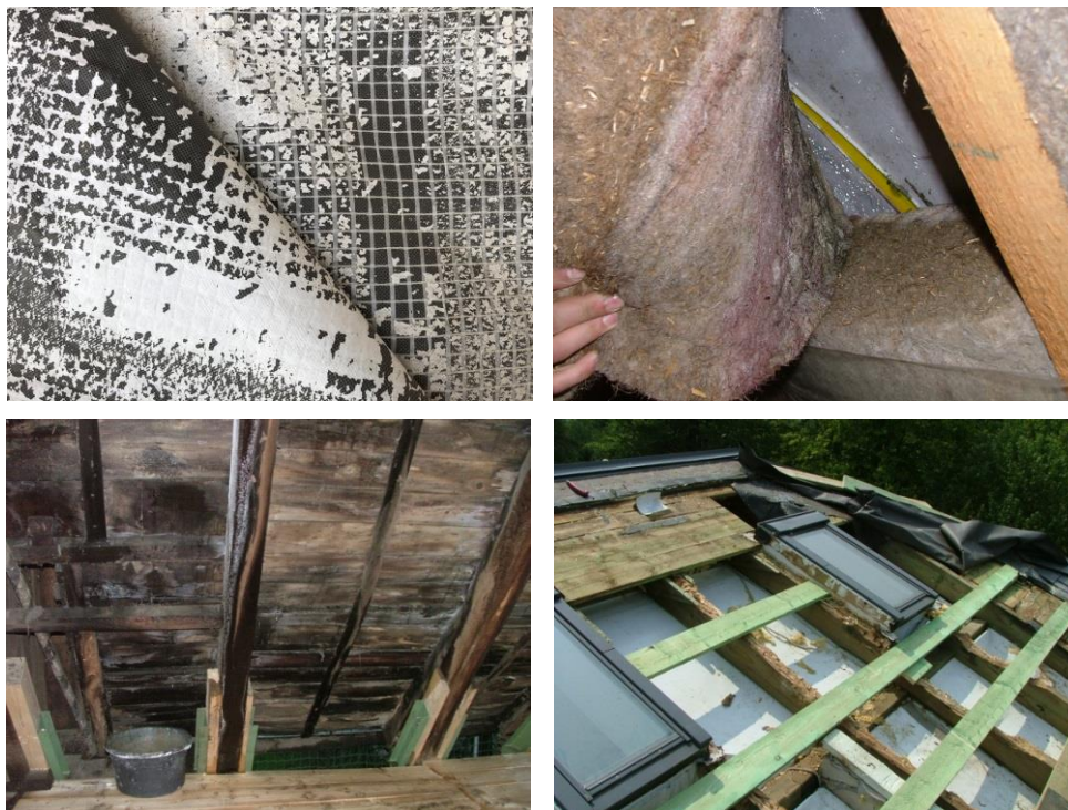
Рис. 2: Поврежденная из-за преждевременного старения мембрана (вверху слева) и последствия для конструкций крыши.
