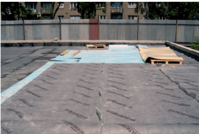
Hotel Yasmín Košice, vegetačná strecha, pojazdná plocha, DELTA®-GEO DRAIN Quattro, plocha: 2500 m 2 , rok realizácie: 2008
