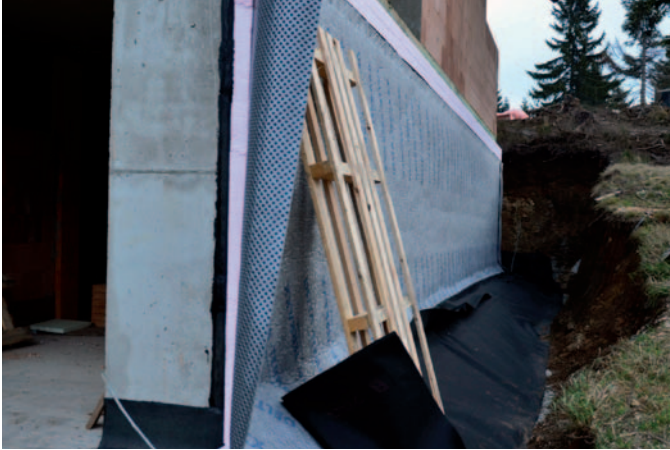
Rodinný dom Martinské hole, zvislá plošná drenáž, DELTA®-TERRAXX, plocha: 120 m 2 , rok realizácie: 2013
